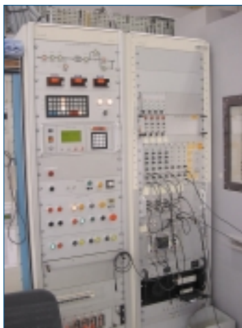
Les connexions hautes tensions arrivent sur l'aiguilleur en face arrière de la baie, inaccessibles pendant les essais et sont sélectionnées sans risque en face avant par contacteurs.
