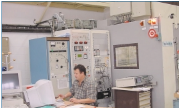
On aperçoit sur cette photo la baie de mesure et la cabine d'essais de court-circuit sur disjoncteurs du laboratoire Ampère de Schneider Electric à Grenoble.
