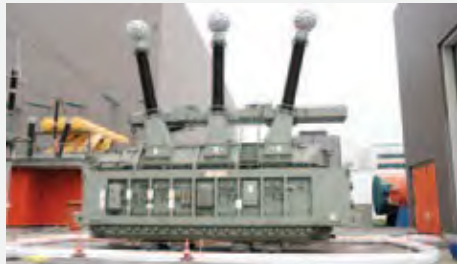
Transformateurs et Inducteurs
